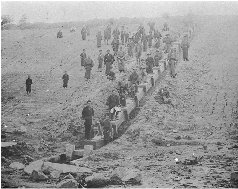
写真3：明正溜(大正3年完成)における斜樋(尺八樋)の施工 (写真提供：滋賀県東近江市平柳明正溜係)
