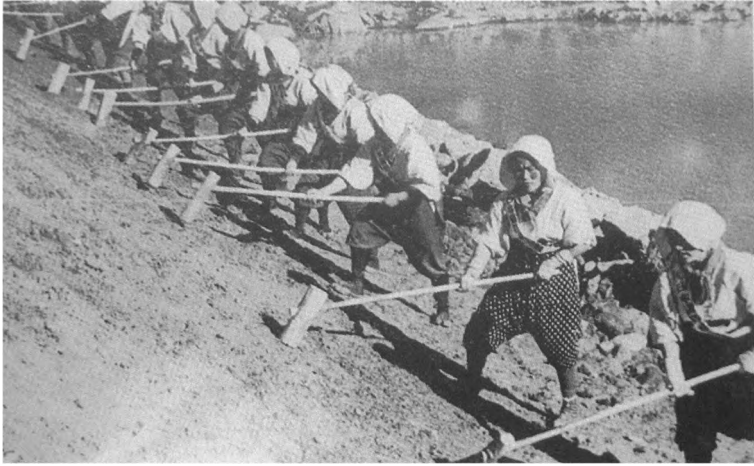
写真4：門入池(寒川町)の築堤工事(藤井誠一氏蔵) (134) (出典：『讃岐のため池誌』，同誌編さん委員会編，2000)
